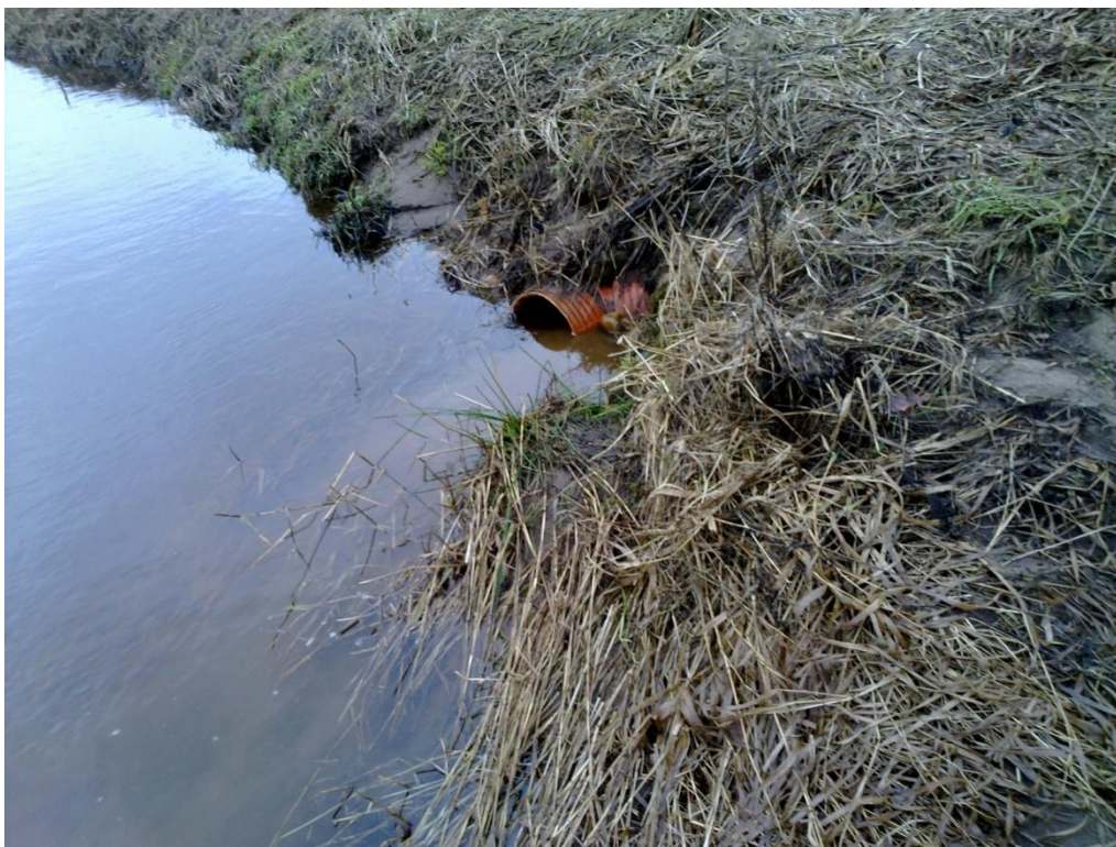
Figur 3. Drænudløb (Ø 40 cm) til Mogenstrup Afvandingskanal. Drænet afvander et større areal ved Karstoft, som det fremgår af tegning 001.
